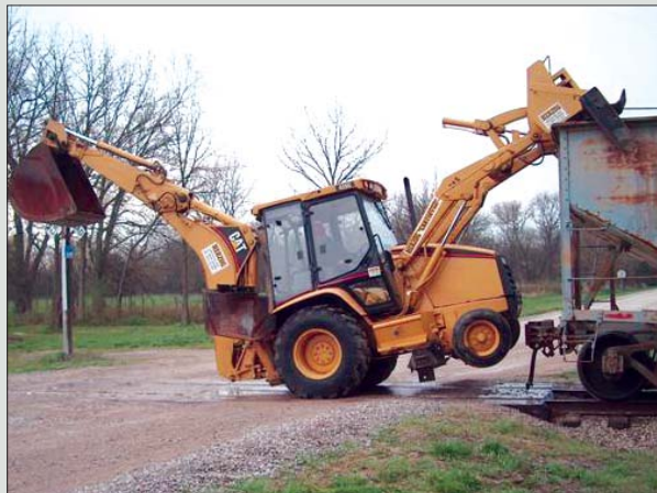
Holowanie maszyn budowlanych określone jest przepisami. Zdecydowanie nie polecamy rozwiązań takich, jak na niniejszym zdjęciu...
