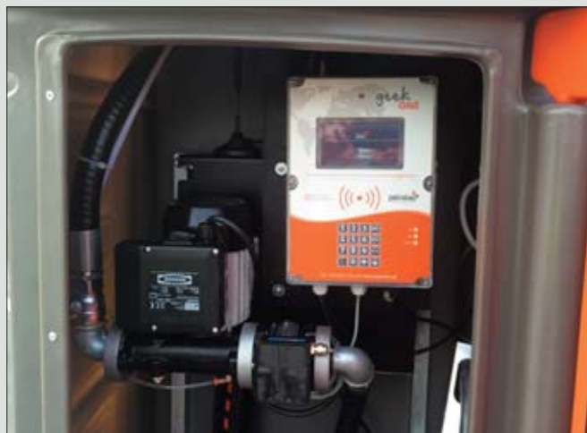
Najbardziej zaawansowane terminale montowane w skrzyniach dystrybucyjnych pozwalają na rejestrację wielu parametrów i ich natychmiastowy, zdalny przesył
