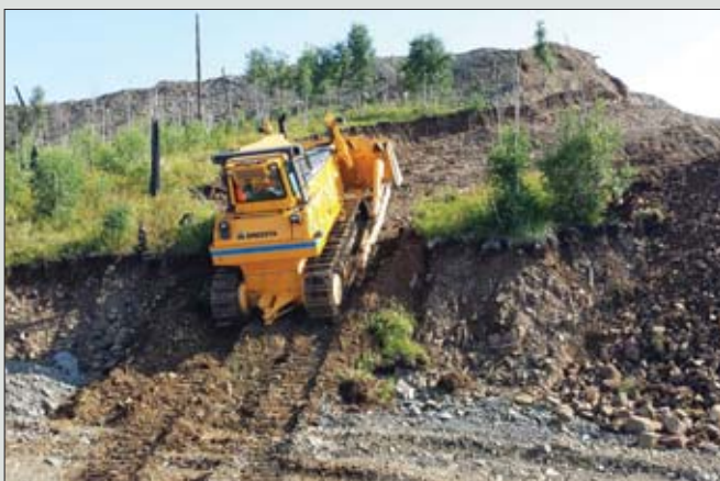
Strome zjazdy i podjazdy oraz nachylenie terenu powodują potencjalne zagrożenia, których pracujący w tak trudnych warunkach musieli być świadomi
