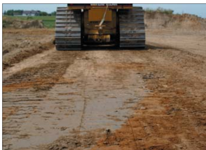
Kontrola dokładności wykonania prac wykazała niezbicie, że spycharka z systemem GCS900 pracowała nie tylko szybciej, ale także ekonomiczniej i dokładniej
