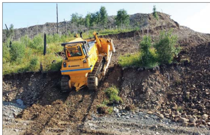
Strome zjazdy i podjazdy oraz nachylenie terenu powodują potencjalne zagrożenia, których pracujący w tak trudnych warunkach musieli być świadomi
