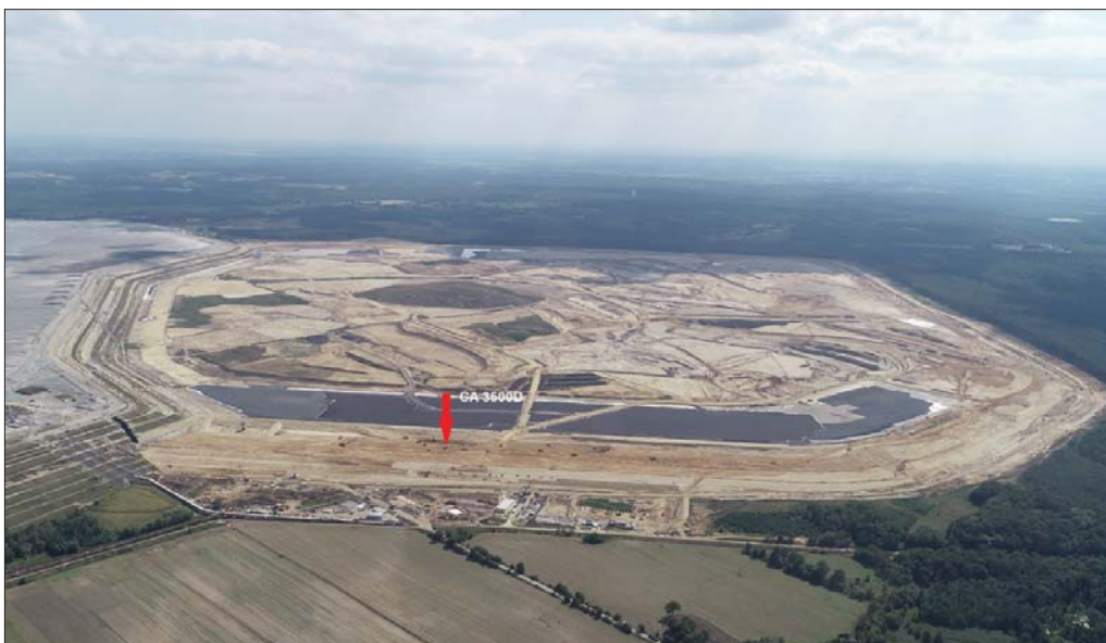
OUOW „Żelazny Most” to największy tego typu zbiornik odpadów w Europie. Przy jego rozbudowie wykorzystywane są także walce do gruntu Dynapac 3500A. Miejsce ich pracy oznaczono czerwoną strzałką
