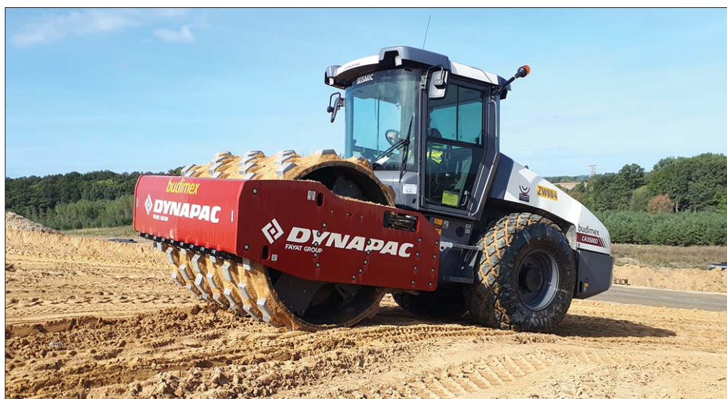
Prace ziemne związane z rozbudową zbiornika „Żelazny Most” są praktycznie zakończone. Przy użyciu walców Dynapac prowadzone są teraz roboty wykończeniowe, instalowanie drenażu materacowego oraz budowa uszczelniających warstw spoistych
