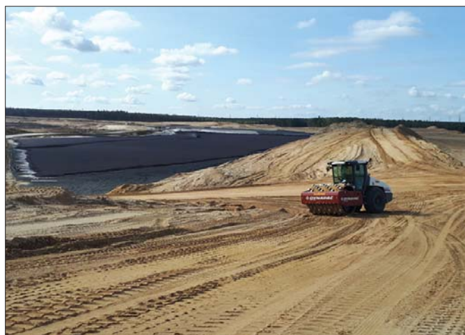
Rozbudowa zbiornika „Żelazny Most” trwa nieprzerwanie od dekad. Obecnych prac nie zahamowała na szczęście nawet pandemia koronawirusa
