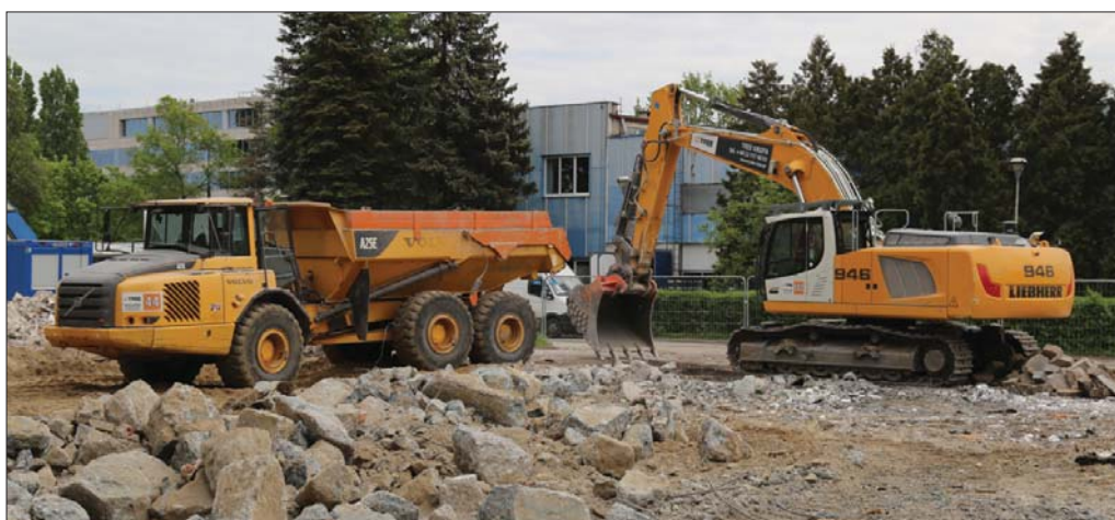
Porządkowanie terenów porozbiórkowych oznacza pracę w specyficznych warunkach. Łyżka koparkowa wykorzystywana jest często w niestandardowych pozycjach, za jej pomocą operator odrywa i przemieszcza resztki elementów konstrukcyjnych burzonych obiektów
