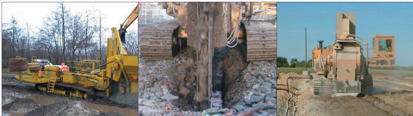
Technologia budowy grodzi polegająca na głębokim mieszaniu gruntu charakteryzuje się szybkością postępowania robót, czystością ekologiczną oraz ekonomią realizacji projektów wynikających bezpośrednio z wysokiej wydajności maszyny
