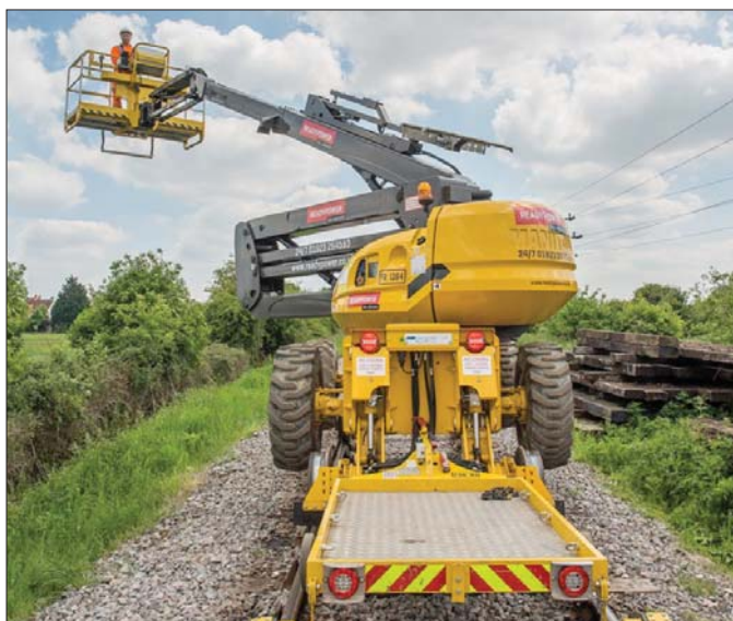
Maszyna ART17TH wyposażona w duży kosz z trzema wejściami i z regałami na narzędzia może wkrótce zrewolucjonizować prace inspekcyjne i remontowe trakcji kolejowej
