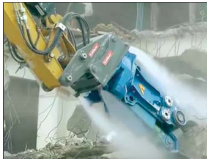
System tłumienia kurzu Dynaset jest ekologiczny, do skutecznego działania nie potrzebuje dużej ilości wody, a tym samym nie powoduje zalania obszaru roboczego
