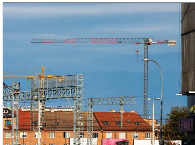
Krupiński Cranes dostarcza najwyższej jakości żurawie wieżowe dla nowoczesnych placów budowy. Z najnowszym modelem będzie można zapoznać się w Nadarzynie
