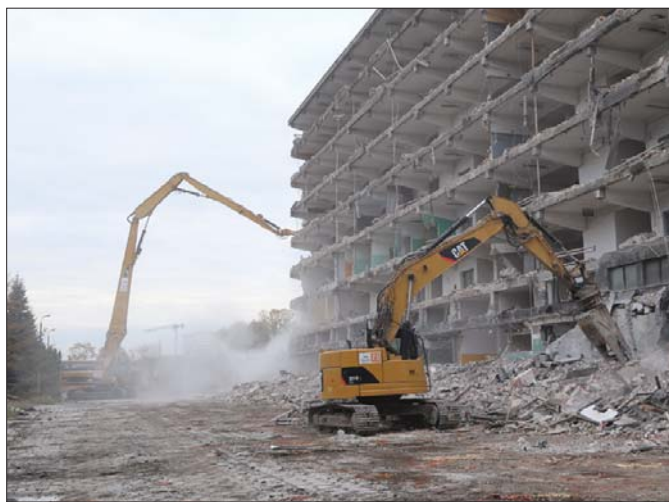
Olbrzymi zasięg sprawia, że można zrezygnować z pracujących na dachach i piętrach na wysokości dwudziestu czy nawet czterdziestu metrów robotników
