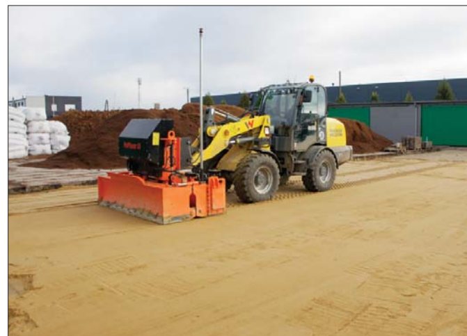
Ładowarka Wacker Neuson z systemem Leica jest w stanie dziennie wyrównać nawet siedem tysięcy metrów kwadratowych powierzchni
