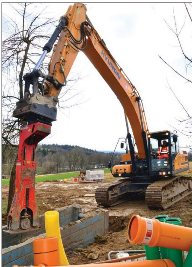
Koparka HX300 LR z wysięgnikiem monoblok i ramieniem o długości 3.500 milimetrów przy budowie kanalizacji została wyposażona w uniwersalną zagęszczarkę marki MTS
