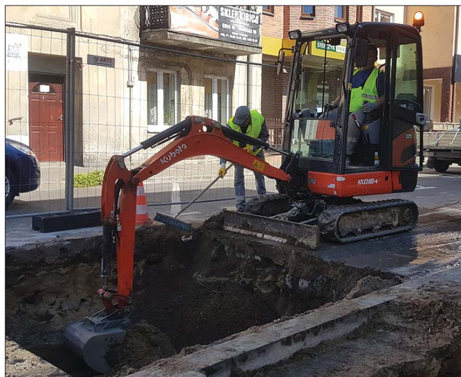
Minikoparka Kubota KX018-4 podczas pracy przy modernizacji przyłącza wodno – kanalizacyjnego na ulicy Toruńskiej w Kole
