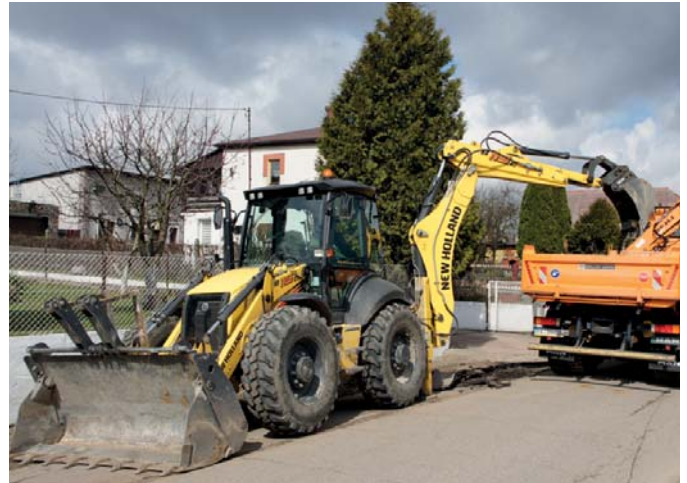
△ Aktualnie koparko-ładowarka B 115C pracuje w miejscowości Radoszki, gdzie wykorzystywana jest przy wymianie nawierzchni oraz budowie kanalizacji burzowej
